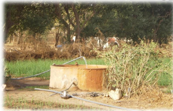
SISTEMA DE BOMBEO SOLAR
