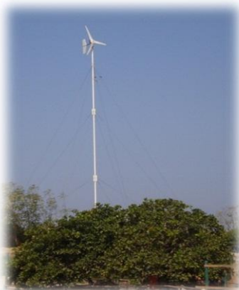
INSTALACIÓN HÍBRIDA SOLAR EÓLICA
