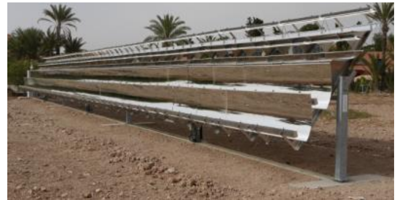
Installation LCPV de 10 kWc à l'ADEREE à Marrakech
