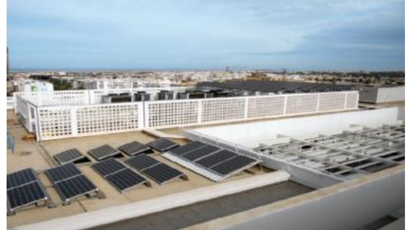
Installation PV à l'ADEREE de 14,5 kWc
